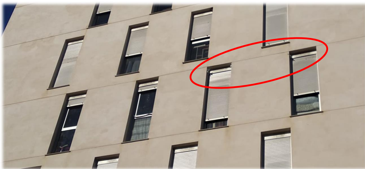
Edifici en l'Avinguda Papa Joan XXIII. S'observa que s'han emprat plàstics per evitar la nidificació de l'avionet després d'haver-ne destruït els nius.
