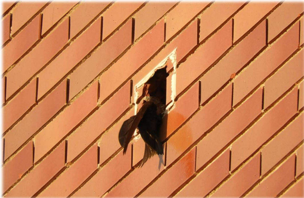
Niu de falcilla comuna en cavitat de ventilació on ha caigut la protecció (C/ Lluís Santapau).
